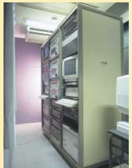
操作室の機器
