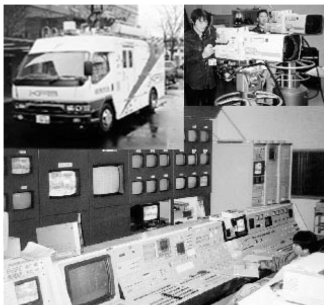
〈福島放送様 放送設備〉
